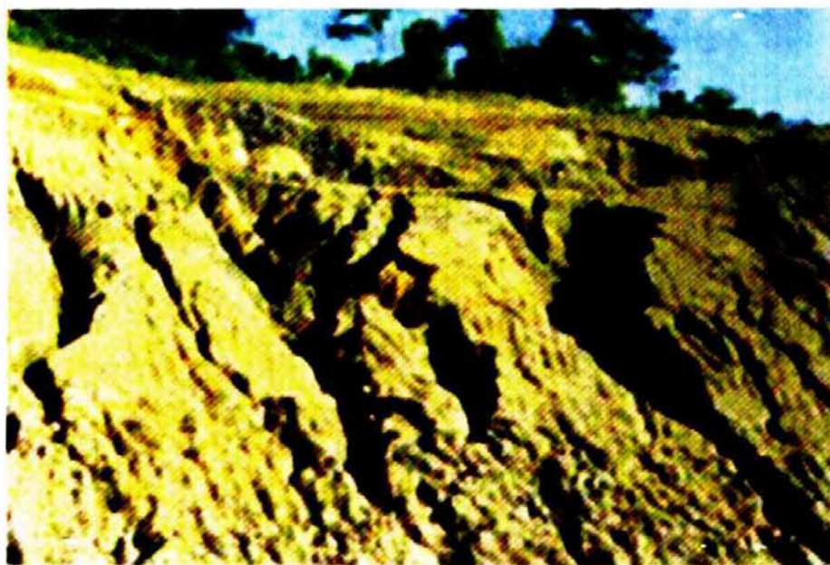
Hình 7. Đất bị xói mòn
